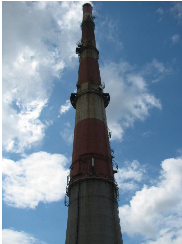
Zał. nr 1: Widok ogólny instalacji radiokomunikacyjnej.
